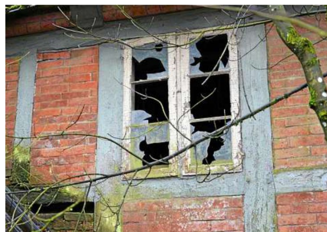
Zerbrochene Fensterscheiben und Spuren von Vandalismus an den Wänden machen die Mühle zum Geister-
